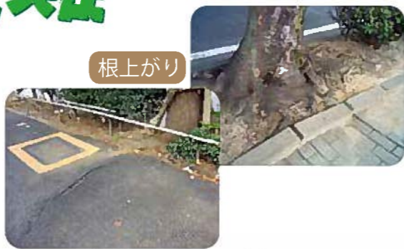
舗装の下に根が入り込み不陸を起こしています。
